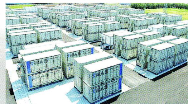
圖為日本最大的鈉硫電池儲能系統案例(50MW/300MWh)
