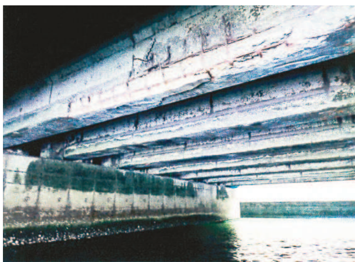
↑台中發電廠進水口龍昌橋老舊多處預力大梁混凝土剝落、鋼筋裸露鏽蝕嚴重，安全堪虞。 (記者陳金龍翻攝)
