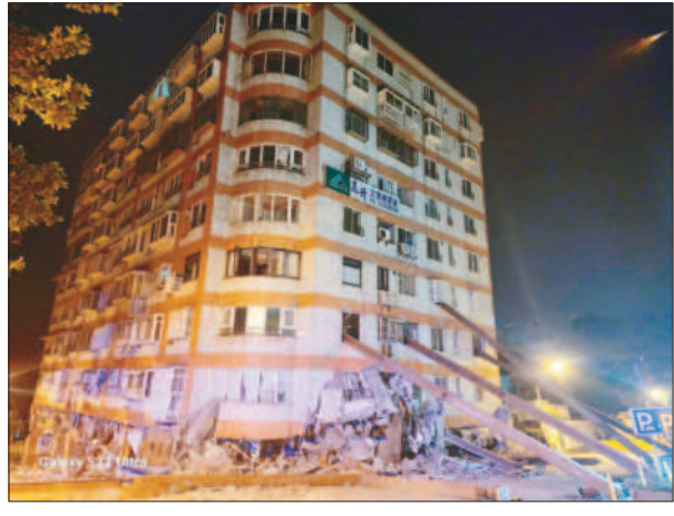
↑四月三日花蓮強震中已被貼紅單的統帥大樓出現傾斜。(中央社)
