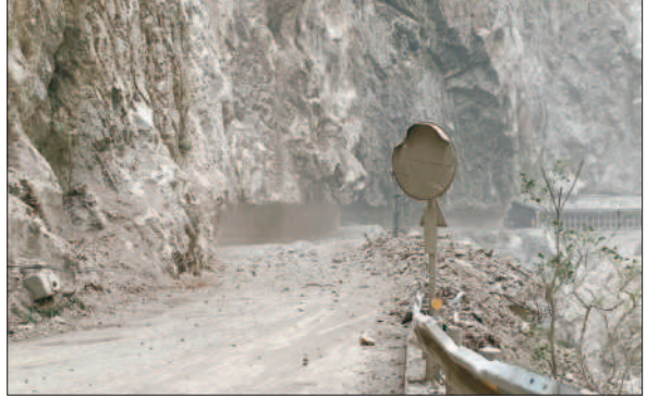
↑中橫公路落石不斷，台八線天祥至太魯閣暫停開放通行。(東區養護工程分局提供)
