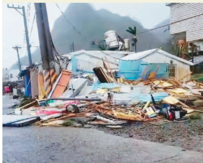
↑蘭嶼全島停電、房屋被吹倒、道路阻斷等慘狀。 (記者鄭錦晴翻攝)
