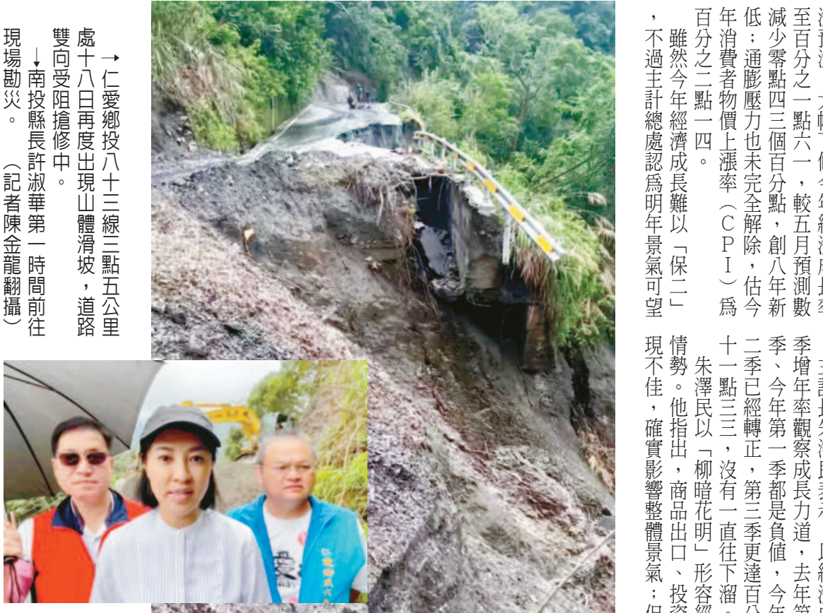
→仁愛鄉投八十三線三點五公里處十八日再度出現山體滑坡，道路雙向受阻搶修中。 ↓南投縣長許淑華第一時間前往現場勘災。(記者陳金龍翻攝)
