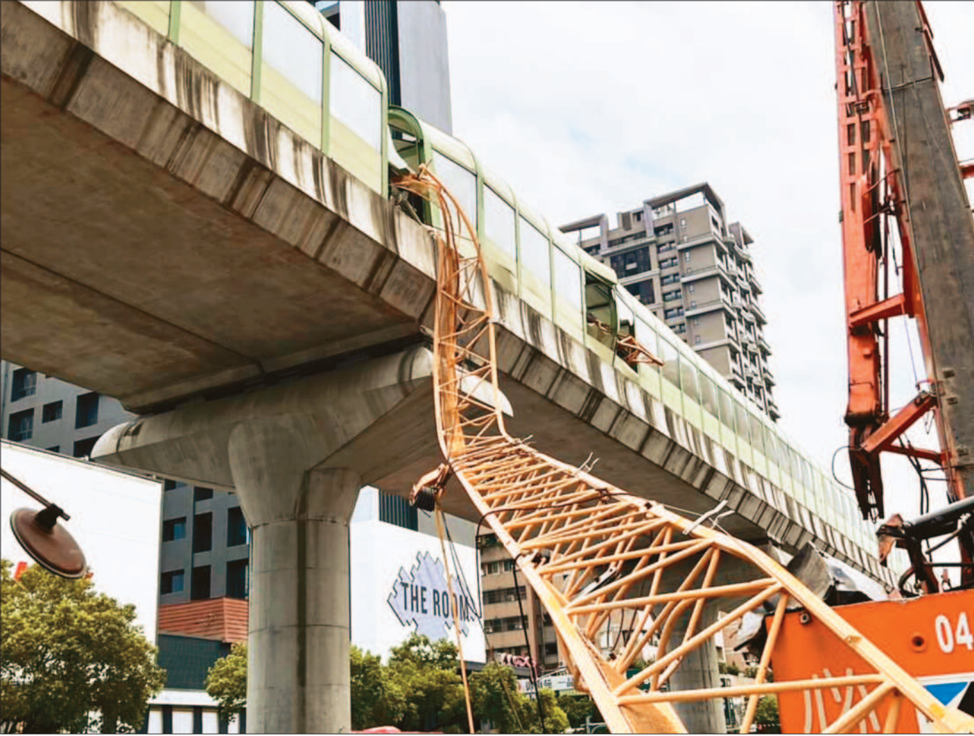
←台中市南屯區文心南五路一處興富發建案，十日發生吊車吊臂倒塌意外，並從三十二樓墜落砸上行駛中的台中捷運車廂，釀一死十傷。 (記者陳金龍翻攝)
