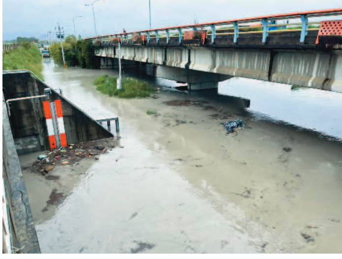
↑↑ 宜蘭縣接連強降雨使得員山鄉七賢村成了水鄉澤國，水淹進農舍庭院。（讀者提供／中央社） ↑ 蘭陽溪主流水位高漲，支流洪水流入七賢村溪洲地區，數十戶村民受困。（宜蘭警方提供）
