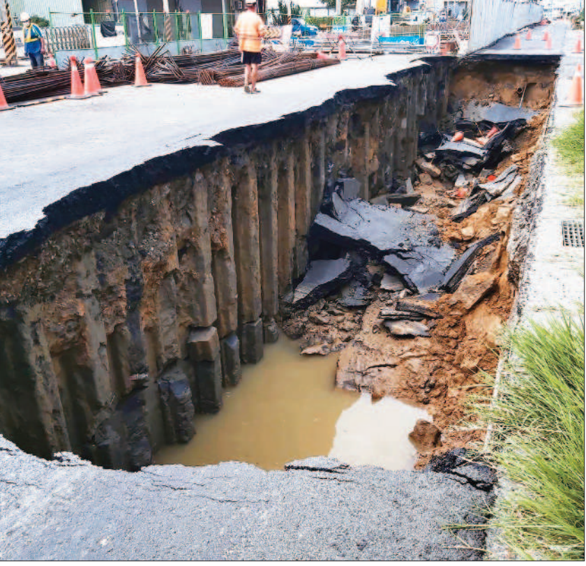
→台南市永康區正南三路路面十五日突傳塌陷，現場出現一個長約三十公尺、寬六公尺、深度五公尺的大洞，目前局部路段雙向封閉搶修中。(讀者提供，中央社)
