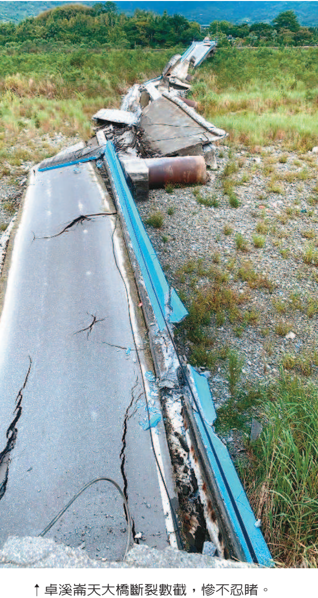
↑卓溪嵩天大橋斷裂數截，慘不忍睹。(花蓮縣消防局提供)
