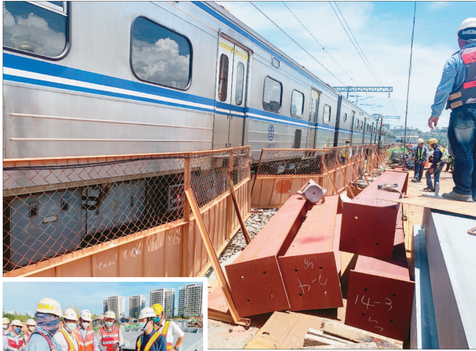
↑南鐵工程因鋼柱吊掛不順，導致圍籬侵入火車行駛路線，擦撞區間車，幸無人受傷，區間車延誤7分鐘後行駛。(鐵道局提供)
