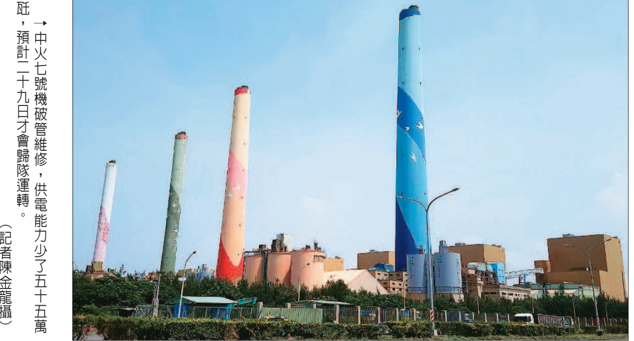
→中火七號機破管維修，供電能力少了五十五萬瓩，預計二十九日才會歸隊連轉。（記者陳金龍攝）
