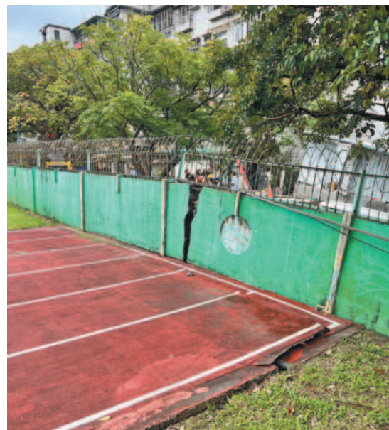
▲道明外僑學校的操場、圍牆出現龜裂。 圖片提供 / 臺北市教育局
