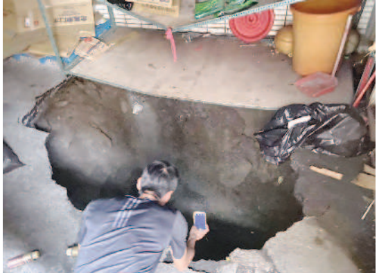
▲基隆市正濱國小疑似因連日大雨，造成資源回收室地板塌陷，昨天傳出一名學生意外掉落約六公尺深的坑洞中。 圖片提供／基隆市政府
