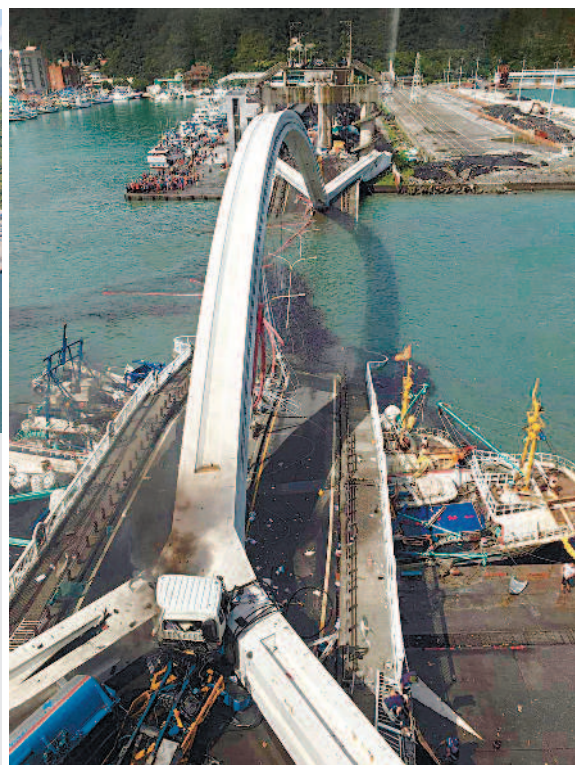
▲宜蘭縣南方澳大橋昨天上午約九點三十分傳出橋梁斷裂意外，橋體直接壓向下方停靠漁船。圖片來源／讀者提供
