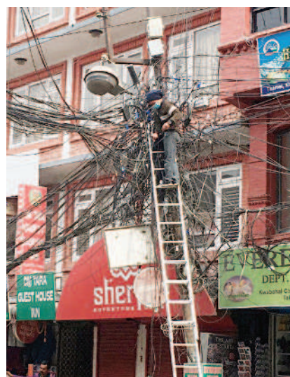
▲改變混亂的配電，是改善不穩定供電的方法之一。
