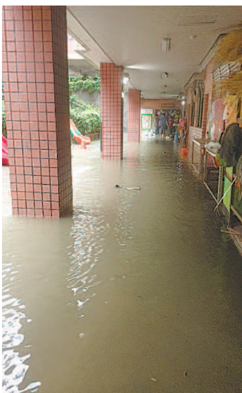
▲臺中市大里區大元國小有多處淹水，波及地下室，許多器材受損。 圖片提供/大元國小
