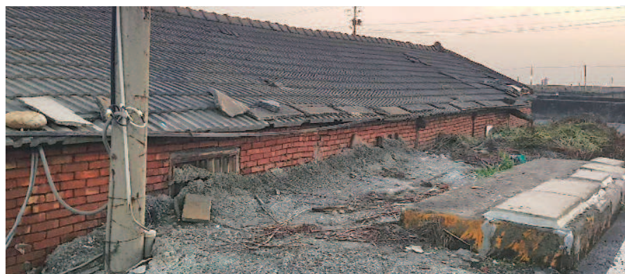
◀彰化縣大城沿海村落，不少房屋明顯陷入地面，窗戶幾乎埋在地下，屋簷貼近地面。 攝影／張彩鳳
