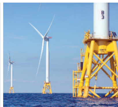
右圖是德國的風力發電廠，左圖是美國羅德島的離岸風電廠。
