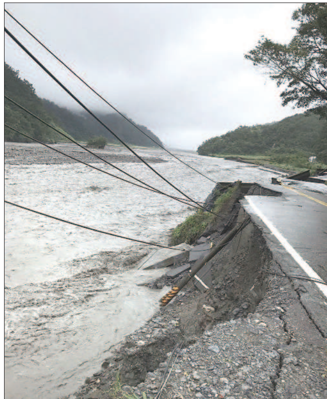
▲宜蘭縣大同鄉臺七線九十三點四公里處，路基被蘭陽溪水掏空，公路總局緊急派員搶修。 圖片提供／宜蘭縣政府
