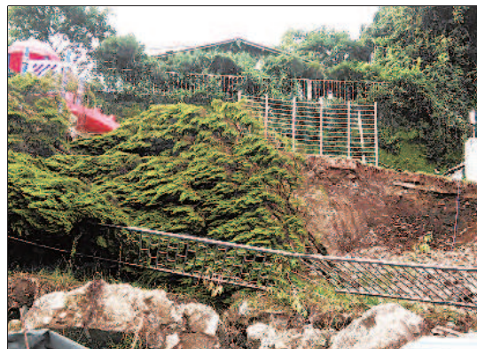
▲日前的大雨造成廬山國小幼兒園圍牆下方坍方，居民和師生都覺得不安全。 圖片提供/廬山國小家長
