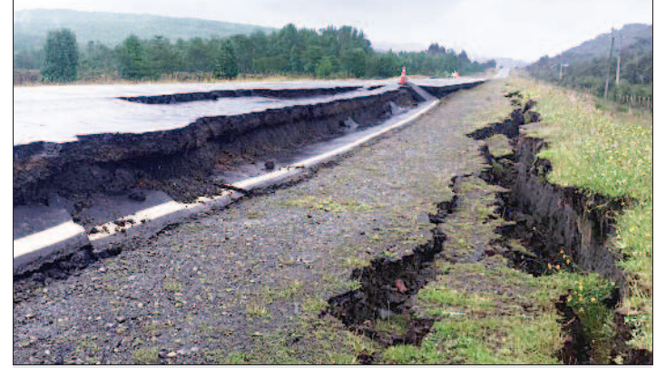
智利7.7強震 智利南部當地時間二十五日發生規模七點七大地震，政府當局一度對數個鄰近海岸發布海嘯警報，並撤離五千名居民。圖為地震過後，智利中南部城鎮克利翁的道路地面出現裂縫。 美聯社
