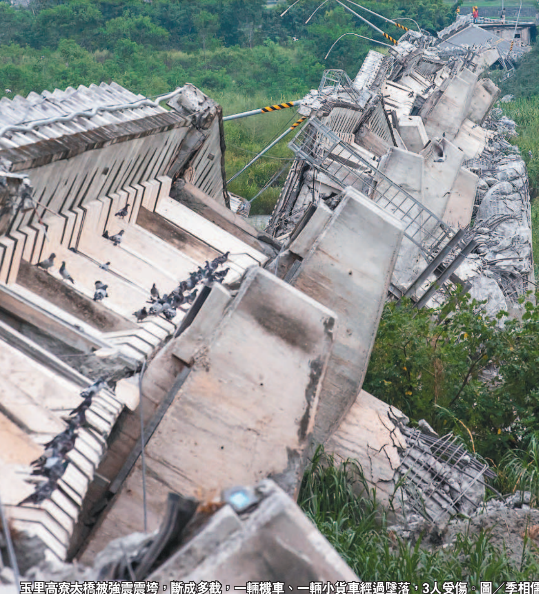
玉里高寮大橋被強震震垮，斷成多截，一輛機車、一輛小貨車經過墜落，3人受傷。圖/季相儒
